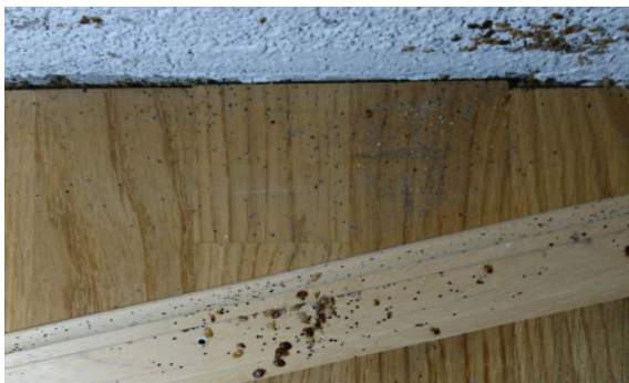
Abb. 1. Starker Befall von Bettwanzen hinter einer Sockelleiste (Foto: Konsag, M. Wyss)
